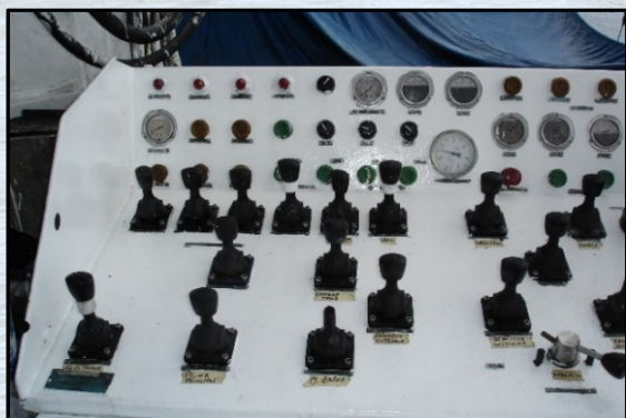
Панель автоматического контроля
